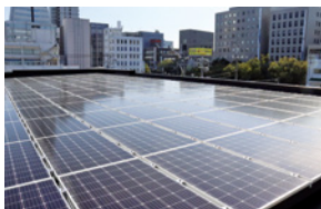
太陽光パネル
